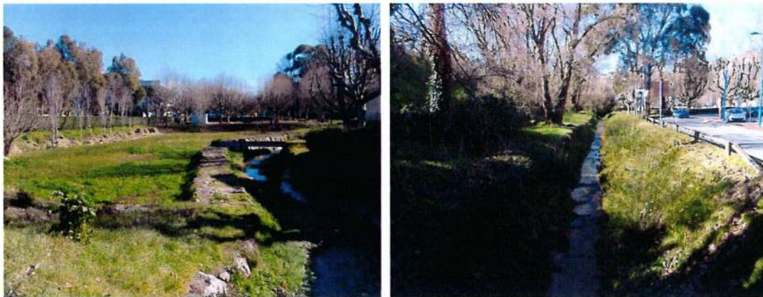
Figure 13 : Vallon de la Théoulière à l'aval de son passage en souterrain – Présence du bassin de rétention en RG (à gauche) et à l'amont de son passage sous l'A8 (à droite)
